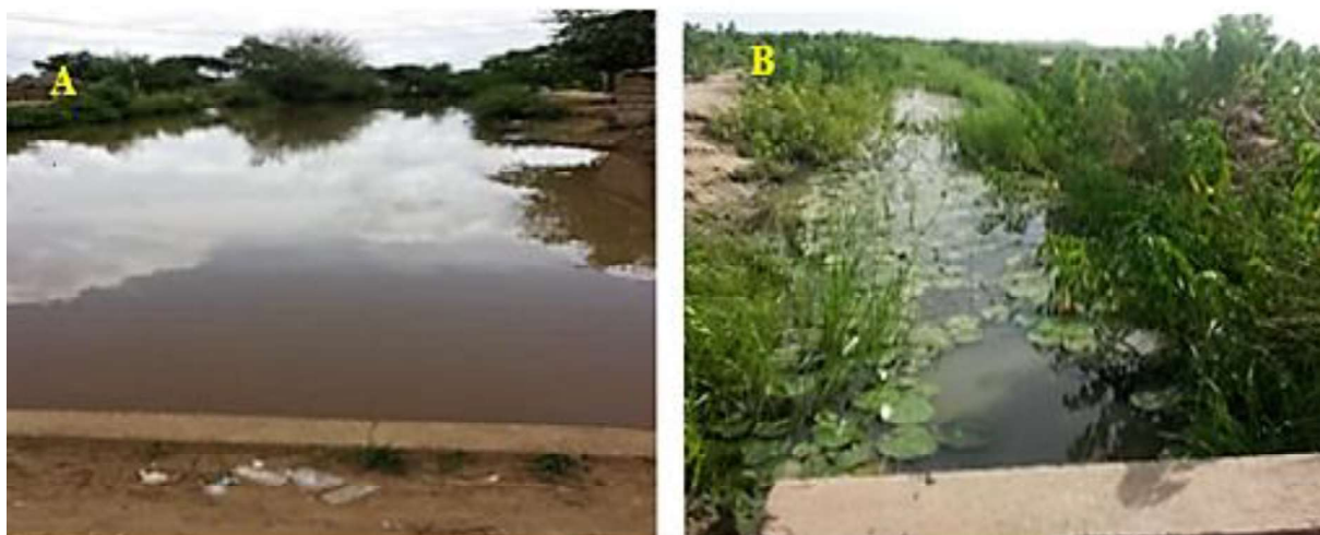
Planche 1 : Vue partielle des canaux envahis par la végétation
