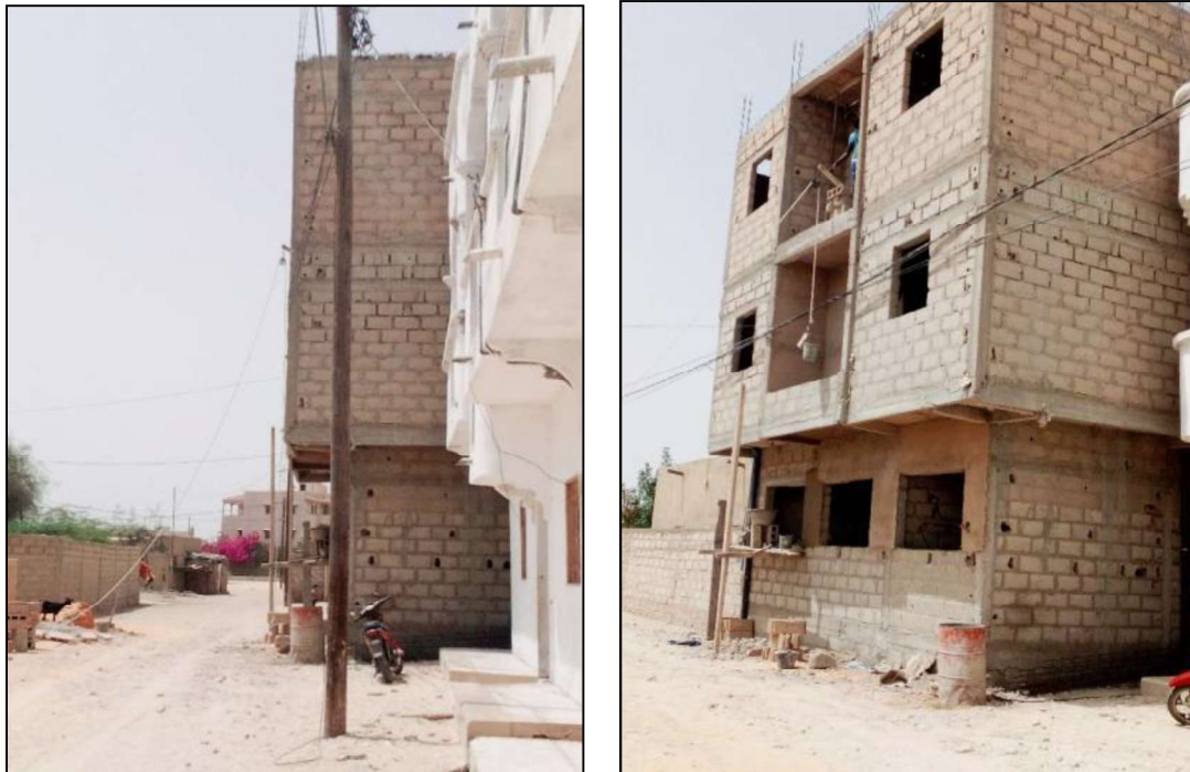
Exemple de violation des articles L40 et L42 de la Section 1 du Code de la Construction Clichés NAKOUYE N., 2020
