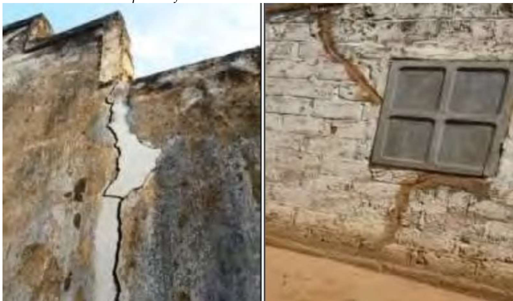
Photo 4 : Exemples de fissuration de bâtiments dans la commune de Diass
