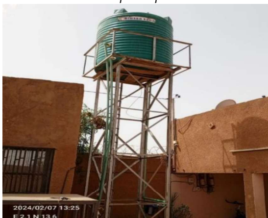
Photo 2 : Forage doté d'un château d'eau en plastique
