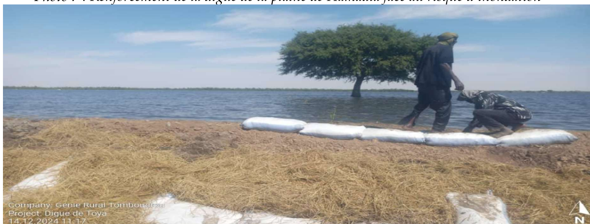
Photo 7 : Renforcement de la digue de la plaine de Hamadia face au risque d'inondation
